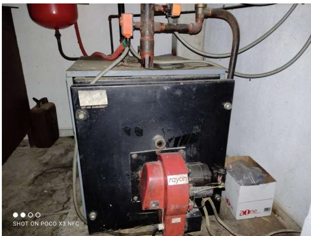
Εικόνα : Μονάδες Λέβητα - Καυστήρα
